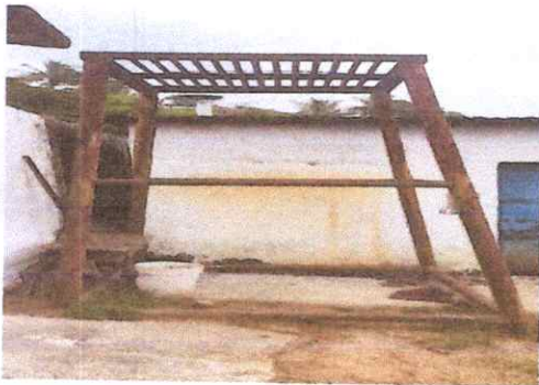
Foto 9 Reparación y mantenimiento de cisternas/ depositos de agua 18.2 sustitucion de deposito de agua 1100 lt
