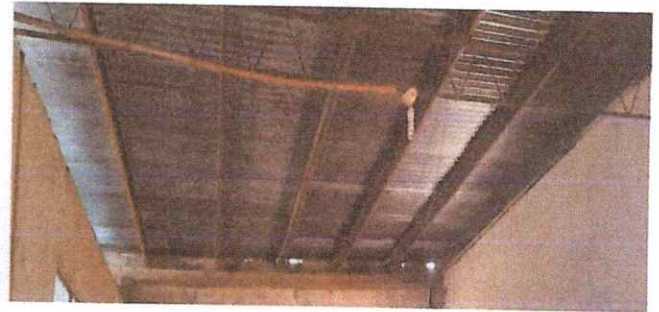
Foto 10: Reparacion del sistema eléctrico 17.4 sustitucion de focos ahorradores, 17.8 sustitucion de tomacorrientes dobles 17.9 sustitucion de filipones 17.11 repacion de cableado electrico
