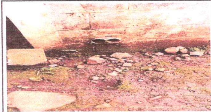
Foto 13: Reparación de Red de Drenaje y Red de Agua Potable 14.4 Sustitución de Tubería PVC línea Principal Aguas plubiales
