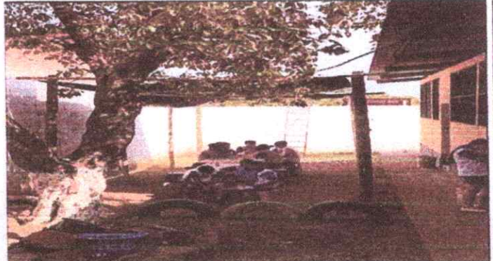
Foto 2: ESTRUCTURA DE TECHO 2.2: Sustrucción de estructura de soporte de madera, por metal
