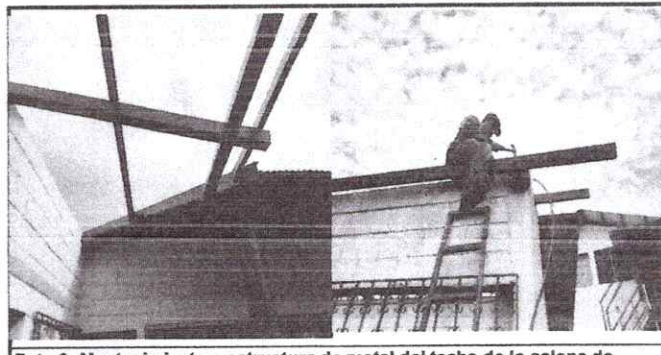
Foto 6: Mantenimiento a estructura de metal del techo de lo salone de claes.
