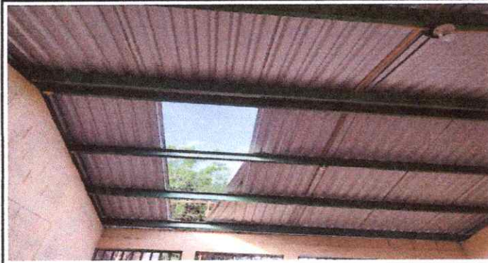
Foto 1: 1.1 Sustitución de lamina, por lamina troquelada aluzinc calibre 26 1.3 sustitución de elementos de fijación
