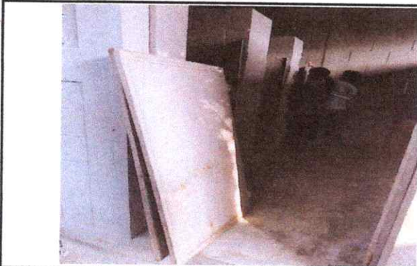
Foto 9: 10.1 Mantenimiento a estructura (lijado, cambio de tubo, cepillado, sujeciones, aplicación de pintura) a puertas de servicios sanitarios
