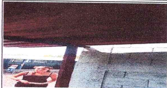
FOTO 2: Sustitución de estructura de soporte de madera, por metal. En el area de cocina.
