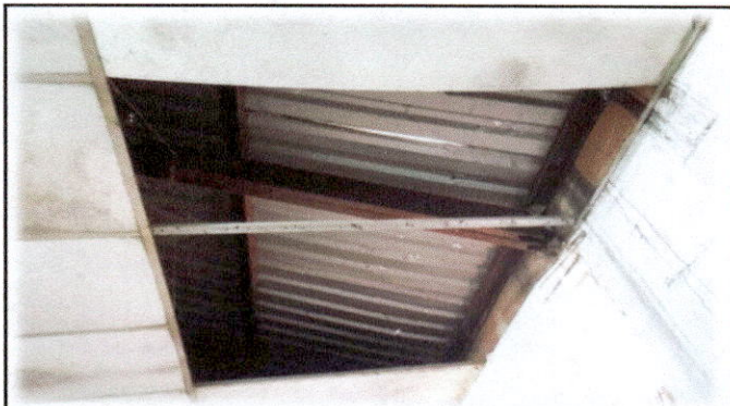
Foto 6: Es necesaria la sustitución de puerta , incluye pintura y chapa.
