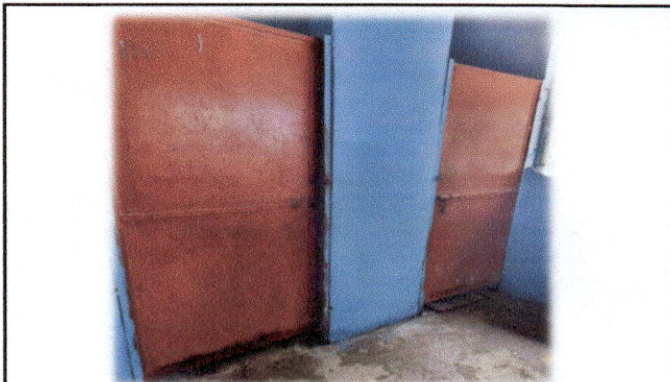
Foto 4: En el módulo de servicios sanitarios, es necesaria la reparación y mantenimiento de las puertas metálicas.
