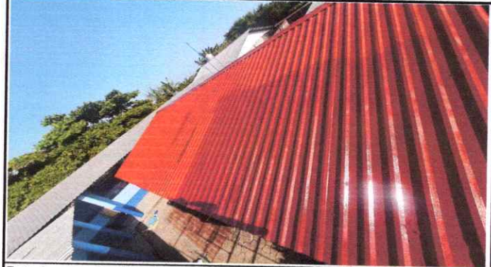
Foto 8: Sustitución de lámina de escenario porque se encuentra dañada.
