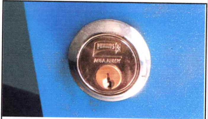
Foto 16: Sustitución de chapa que se encuentra en mal estado de las puertas de la cocina.
