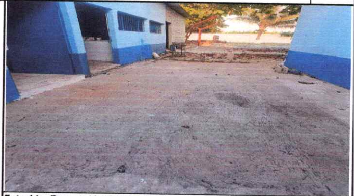
Foto 14: Reparación de piso de torta de concreto, que está en mal estado.
