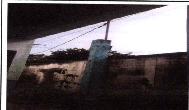
Foto 9: Cambio de tubo que se encuentra dañado y su respectivo cableado electrico.
