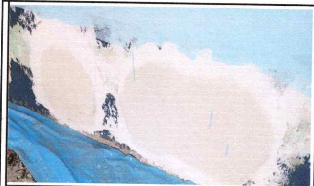
Foto 13: Repello de paredes y pintura que se encuentran en mal estado en área del establecimiento.
