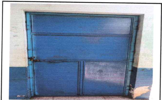
Foto 15: Sustitución de puerta del aula, que se encuentra en mal estado.
