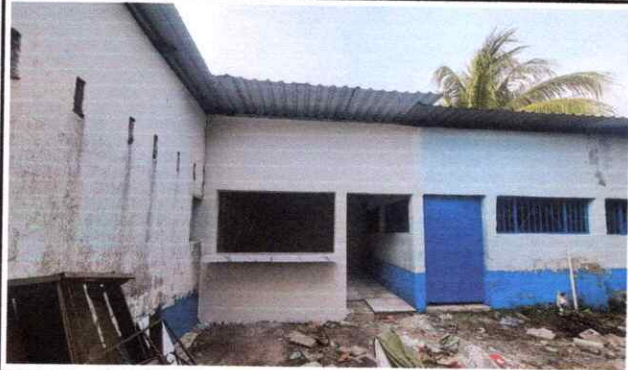
Foto 1: Pared en mal estado necesitan repello y pintura.
