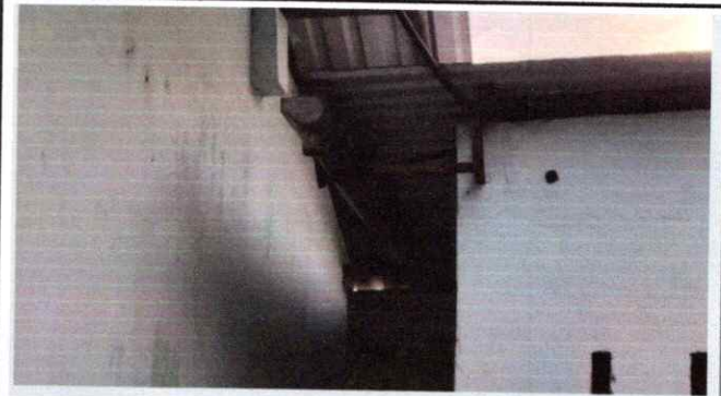
Foto 2: Canaletas en mal estado es necesario de cambiarla con su tubería.
