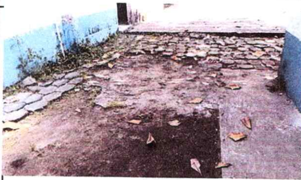
Foto 13: Reparación de piso de torta de concreto, que está en mal estado.
