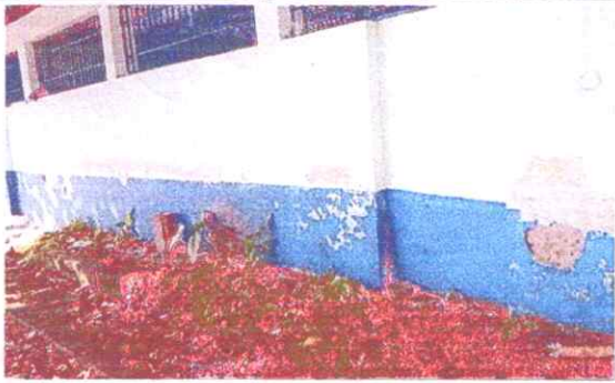
Foto 1: Pared en mal estado necesitan repello y pintura.
