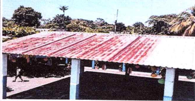
Foto 8: Sustitución de lámina de escenario porque se encuentra dañada.
