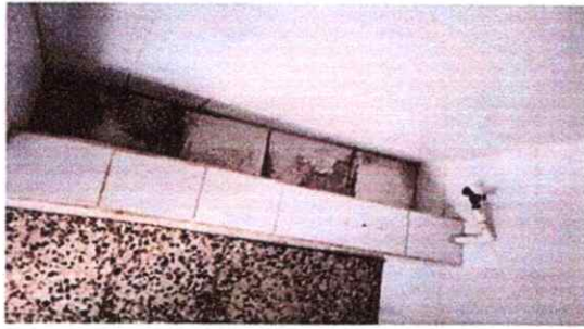
Foto 7: Reparación y mantenimiento de mingitorio porque se encuentra tapado
