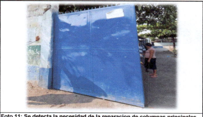
Foto 11: Se detecta la necesidad de la reparación de columnas principales de apoyo para el portón y el cambio e instalación del portón metálico.
