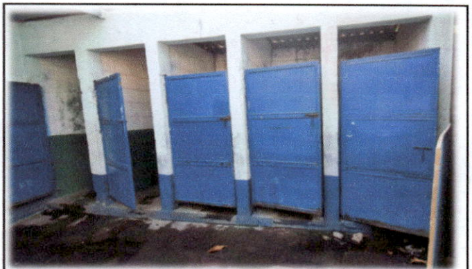
Foto 4: Es necesaria la reparación y mantenimiento de puertas en el módulo de servicios sanitarios.
