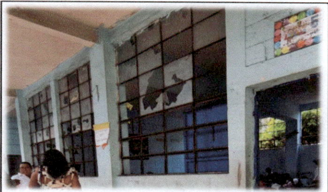
Foto 10: Es necesaria la reparación puertas y balcones, incluye lijado y pintura.
