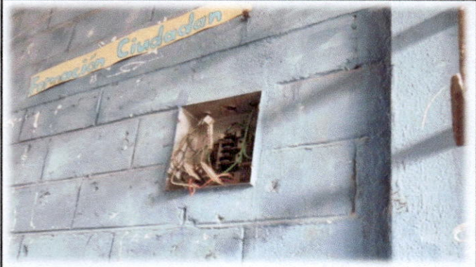
Foto7: Es necesario el cambio de tablero de flipones y flipones.
