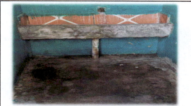
Foto 5: En el módulo de servicios sanitarios es necesario el cambio e instalación de piso antideslizante.
