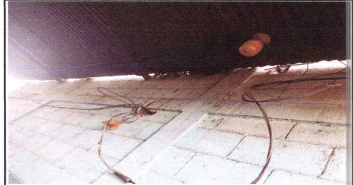
Foto 2: Sustrucción de soporte de metal por metal en modulo de cocina
