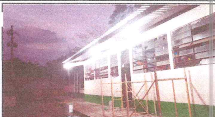
Foto 2: Sustitución de bombillas y reflectores y cambio de elementos deteriorados o dañados (cables, plafoneras, apagadores, etc.)
