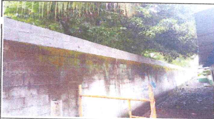
Foto 3: Se levantaron dos bloques más de block y se taparon los agujeros con cemento. Con la finalidad de seguridad al edificio público.
