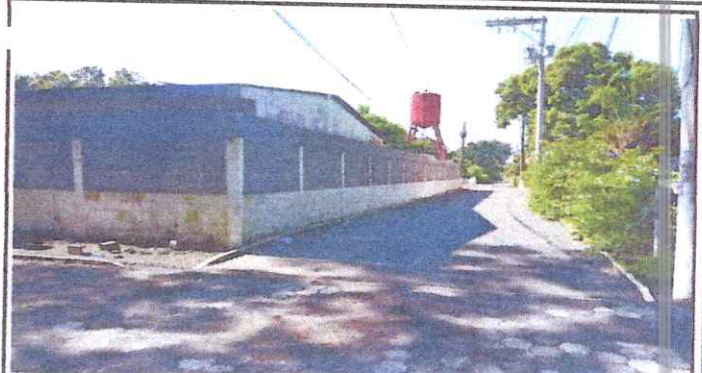
Foto 2: Sustitución de malla por pared (block), levantar dos bloques más y colocar rasor, con la finalidad de asegurar la Escuela. Sernido y pintura en el exterior.
