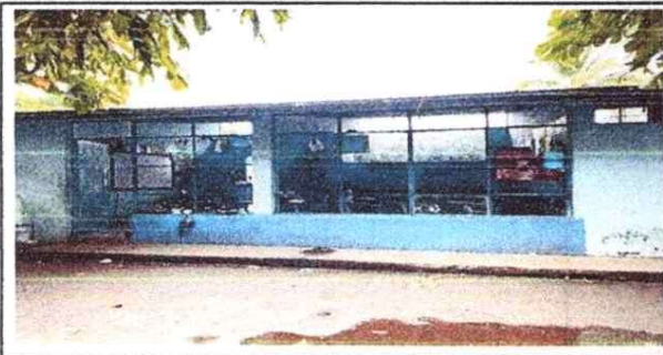
Foto 5: Sustitución de ventana de vidrio por muro de block en módulo aula.
