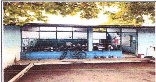
Foto 4: Sustitución de ventana de vidrio por muro de block en módulo aula.
