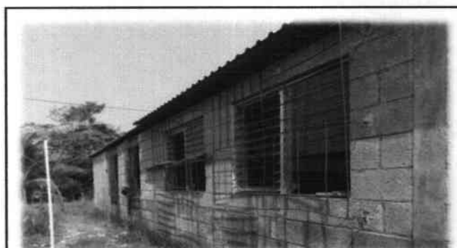
Foto 10: Es importante el cambio e instalacion de balcones.
