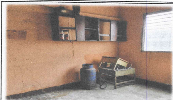
Foto 8: Se detecta la necesidad de reparación y mantenimiento de puerta principal y de gabinete en el módulo de cocina.
