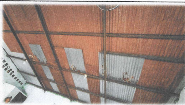
Foto 11: Es necesario el cambio e instalación de estructura de soporte metal por metal.
