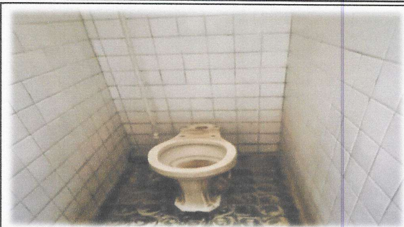
Foto 2: Estado de los inodoros en los servicios sanitarios que muestran gran deterioro.
