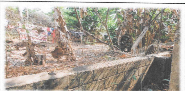
Foto 11: El muro perimetral de block mas malla galvanizada con tubo hg se encuentra en malas condiciones. Y presenta inseguridad para el establecimiento.
