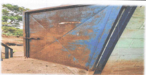
Foto 5: Las puertas de los inodoros se encuentran oxidadas, se evalua la necesidad de sustituir por puertas en mejores condiciones.
