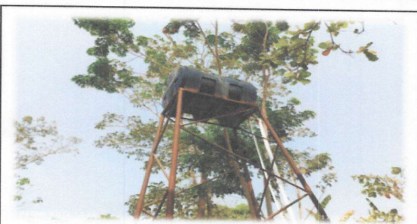
Foto 9: El deposito de agua se encontró sin uso, por daños tanto en el como grietas, asi tambien en el kit del flote.
