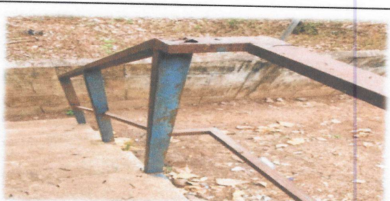
Foto 6: Las barandas actuales tambien presentan deterioro e inseguridad en su función.
