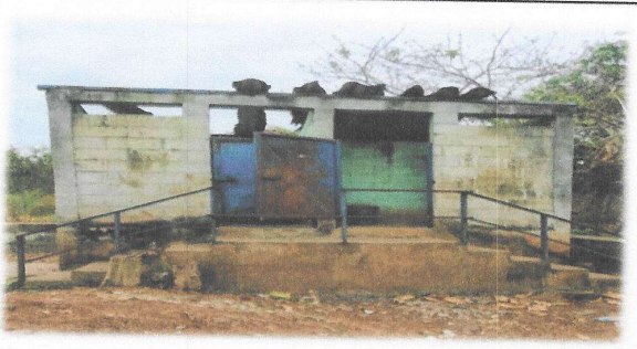
Foto 3: Actualmente los servicios sanitarios se encuentran en pesimas condiciones.
