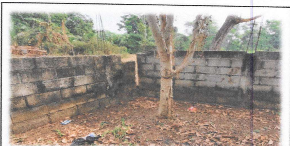
Foto 12: La esquina Sureste del muro perimetral se encuentra totalmente inestable.
