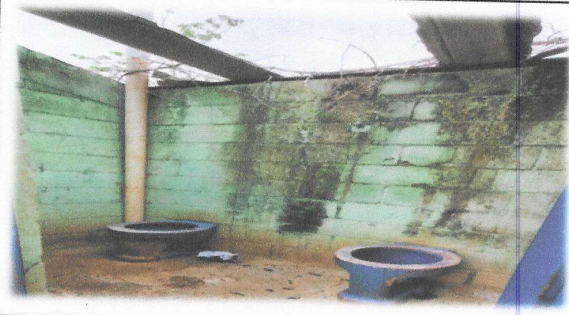
Foto 4: La cubierta de los servicios sanitarios, es uno de los mayores problemas que presenta el modulo.
