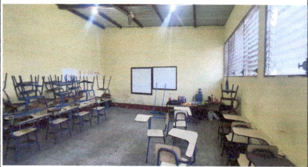
Foto 4: Foto de techo donde existe filtracion de agua
