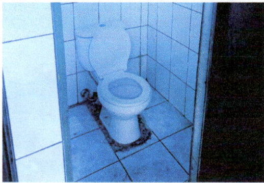
Foto 3: Baños sin sistema de drenaje
