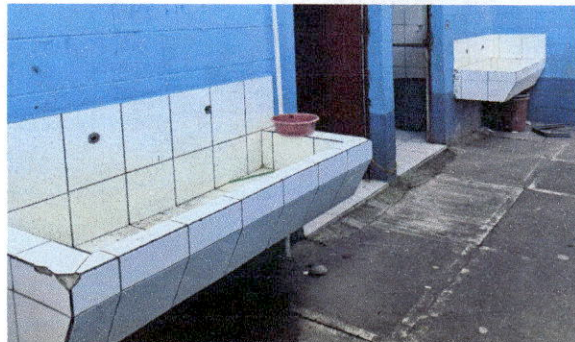
Foto 6: Pileta para lavmanos
