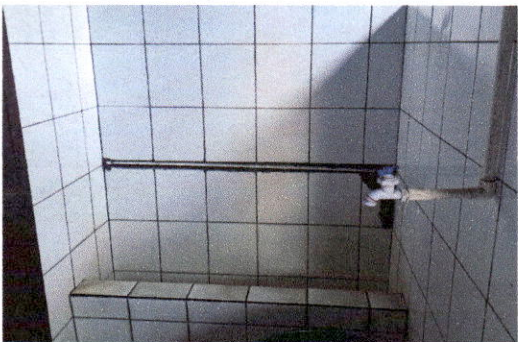
Foto 5: Mingitorio sin sistema de drenaje
