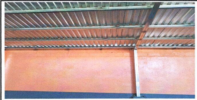
Foto 2 : 2.3 sustitución de estructura de soporte de metal, por metal soporte de metal por metal nuevo finalizado
