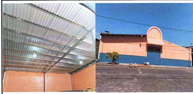
Foto 7 9.1 pintura en muros interiores y exteriores La fotografía muestra el Trabajo de pintura finalizado muros interiores y exteriores del establecimiento .
