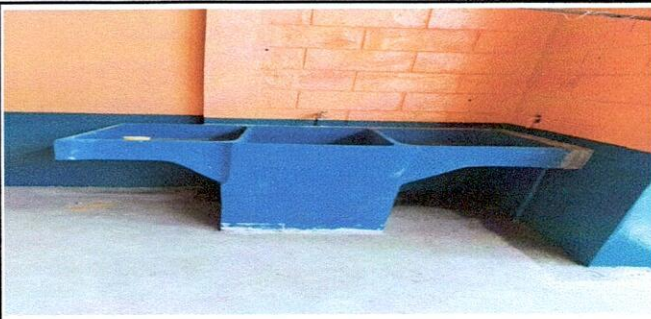
Foto 22 : 20.10 Sustitución de pila de cemento de dos lavadero Esta fotografia muestra la pila de dos lavaderos de cemento ya instalada en el espacio de juegos .
