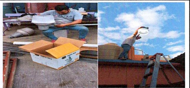
FOTO 11: 17.4 Sustitución de focos ahorradores Esta fotografía muestra la sustitución y conexión de foco ahorrador
