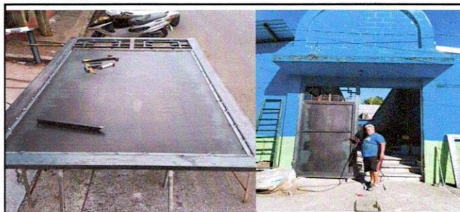
Foto 18: 19.5 Fabricación e instalación de portón de metal de ingreso Esta fotografía muestra la elaboración y proceso de instalación del nuevo portón.
