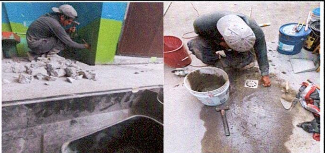
Foto 9 : 14.1 mantenimiento a reposaderas ( Esta fotografía muestra el trabajo realizado en reposaderas de drenaje y caídas de agua)
