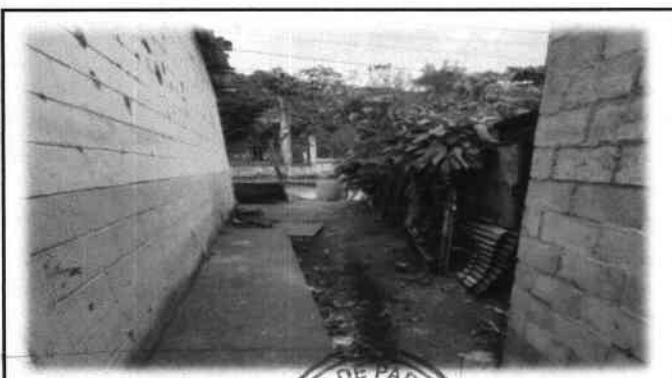
Foto 11: La escuela cuenta con un problema importante y es acerca de su muro perimetral, ya que actualmente no tienen limitado todo el terreno que les pertenece, los colindantes tienden apropiarse del terreno de la escuela. Mayormente en su lado Este y Sur.
