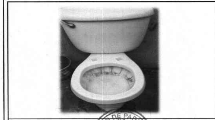
Foto 5: Se cambiarán eh instalarán 7 tapaderas para inodoros, ya que se encuentran quebrados y deteriorados.
