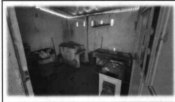
Foto 8: Reparación y mejoramiento en el modulo de cocina, se encuentran diversos trabajos a realizar, como la reparación de la estufa de leña rural y de los muebles de cocina.
