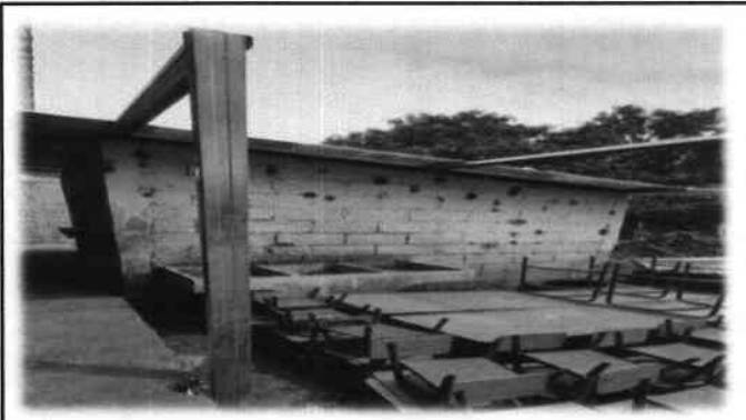
Foto 9: Cambio e instalacion de lamina troquelada aluzinc calibre 26, del modulo de cocina y area de pilas.
