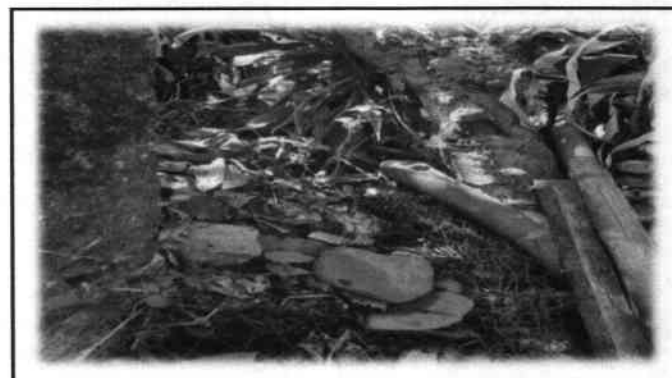
Foto 12: En donde se encuentra el muro, se puede observar que se necesita reparar la estructura vertical e horizontales (columnas y soleras) como tambien el tubo hg y malla galvanizada.
