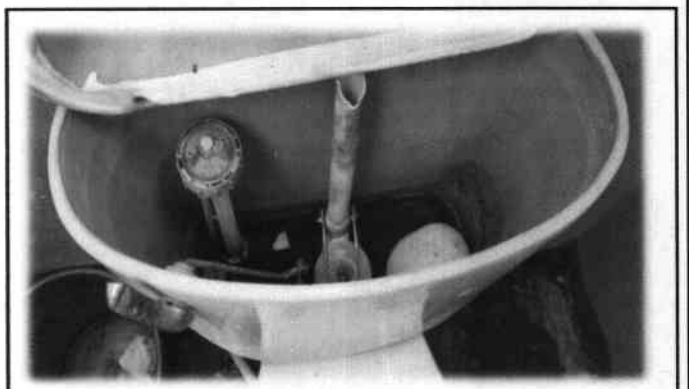
Foto 4: Se cambiarán eh instalarán 7 kit completo y tapadera para inodoros, ya que se encuentran quebrados y deteriorados.
