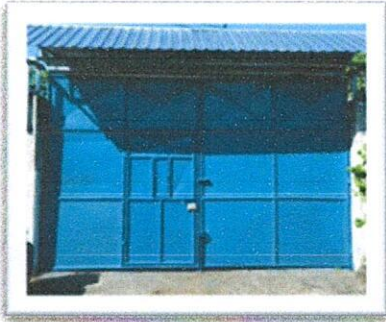
Foto1:porton dañado por lluvia, sol colocacion de pestaña
