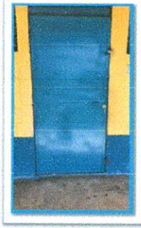
Foto 1: Mantenimiento a estructura de puertas (lijado, cambio de tubo , cepillado, sujeciones, aplicación de pintura)
