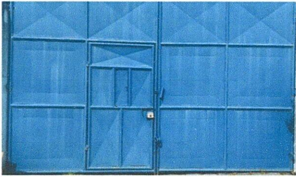
Foto 3: Corrosion en porton en estructura y lamina
