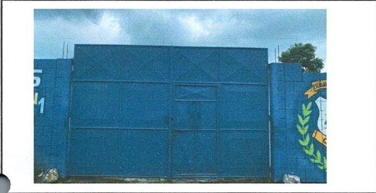
Foto1: porton dañado por lluvia, sol colocacion de pestaña
