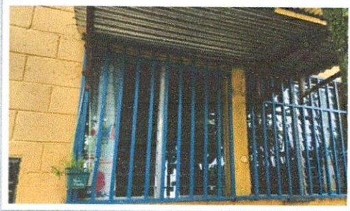
Foto 5: Balcones en mal estado por corrosión y antigüedad
