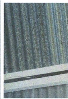
Foto 2: Cableado electrico en mal estado
