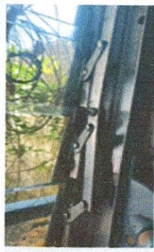
Foto 3: Corrosión, polvo, la suciedad y la humedad marcos de aluminio mill finish
