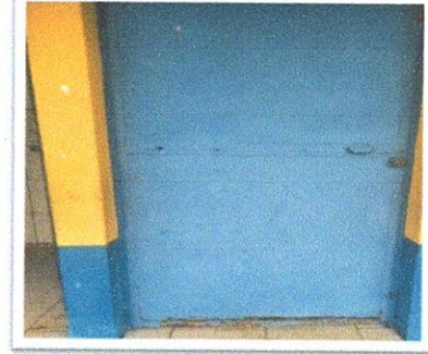
Foto 2: Puerta de metal de la estructura y lamina oxidado del servicio sanitario entrada a los baños
