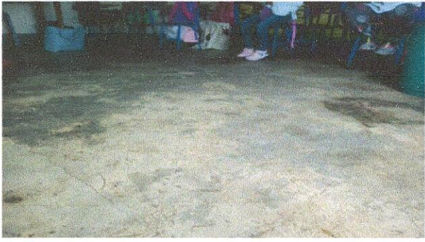
Foto 1: Piso de torta de concreto dañado manchado y agrietado
