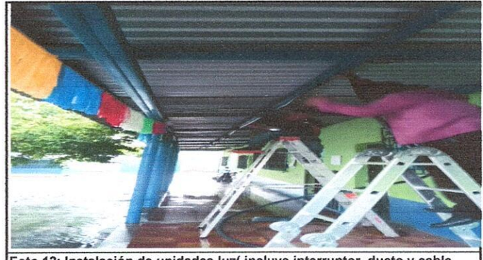
Foto 12: Instalación de unidades luz( incluye interruptor, ducto y cable eléctrico. Corredor de los salones.
