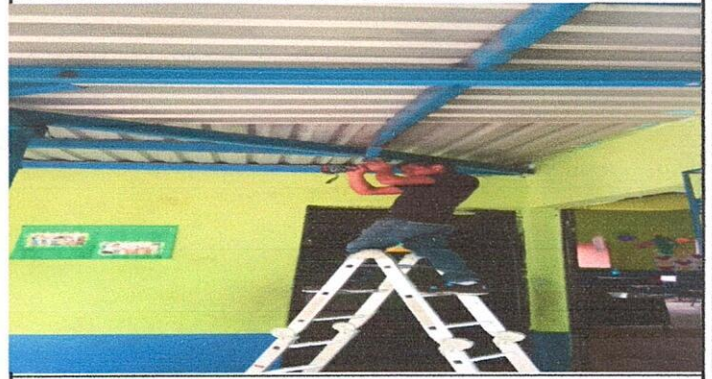
Foto 14: Instalación de unidades luz (incluye interruptor, ducto y cable eléctrico)corredor de la escuela.
