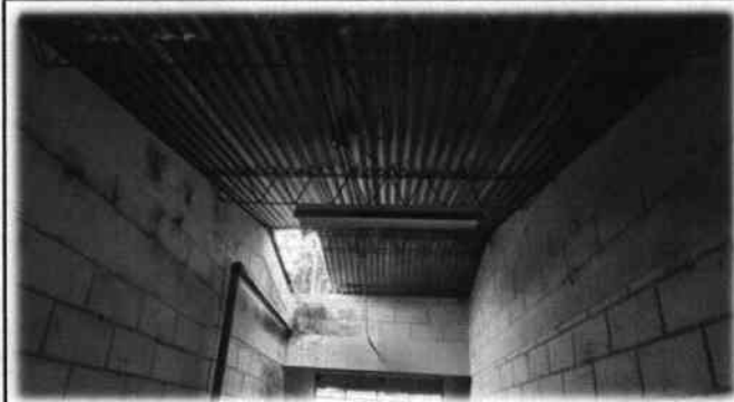
Foto7: Dentro de los deterioros detectados se encuentra la pérdida de láminas completas.
