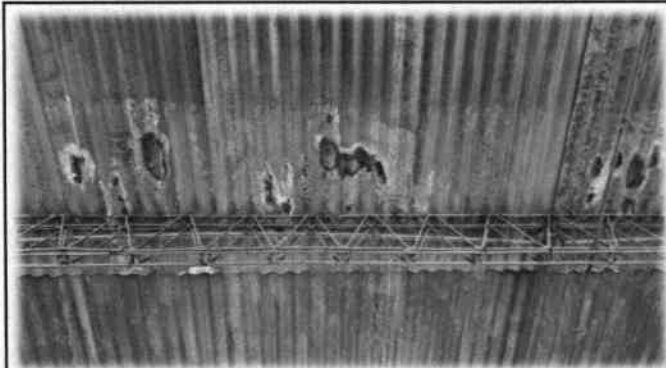
Foto 3: Es notable el deterioro de las láminas acanaladas con las que actualmente cuenta cada uno de los módulos de aulas.
