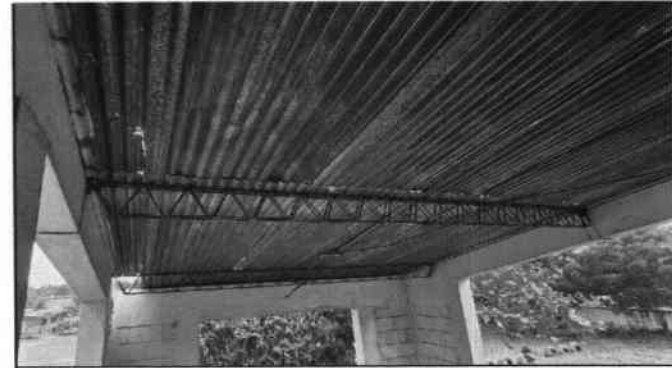
Foto 6: Módulo de gradas techado con lámina acanalada con muestras de serio deterioro.
