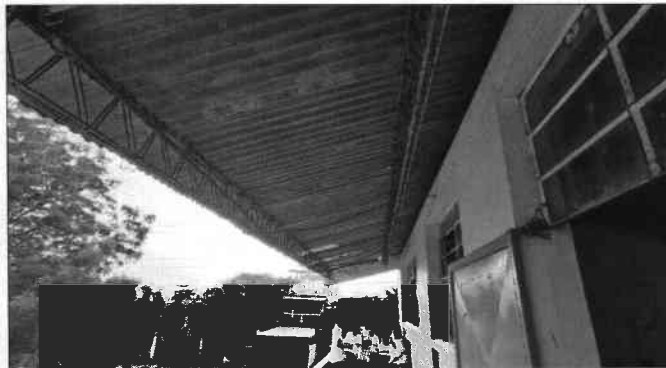
Foto 5: Tanto el interior de las aulas como los pasillos tienen el mismo tipo de lámina y presentan el mismo tipo de deterioro.
