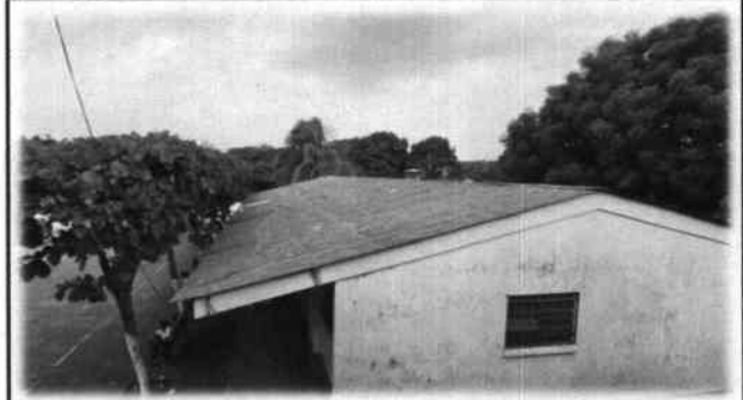
Foto 8: Es necesario el cambio e instalación de lámina, por lámina troquelada aluzinc calibre 26 (incluye tornillos) en módulo de aulas.
