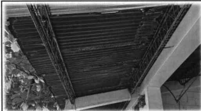
Foto 9: Pasillo de uno de los módulos de aulas que muestra el severo deterioro de las láminas acanaladas.
