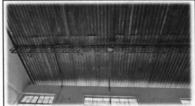
Foto 4: Es necesario elambio e instalación de lámina, por lámina troquelada aluzinc calibre 26 (incluye tornillos) en módulo de aulas.
