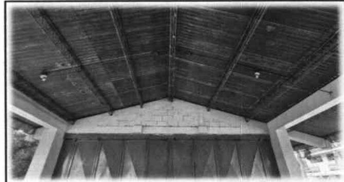
Foto 12: Se detecta la necesidad del cambio de las láminas acanaladas en los módulos de aulas.
