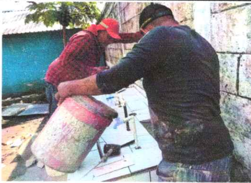
Foto 3: Sustrition de tubo de abasto de mezcladora de lavamanos
