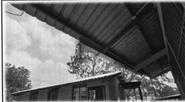
Foto 8: Es necesario el cambio e instalación de canal PVC.
