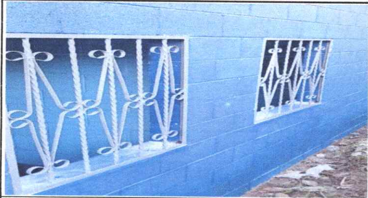
Foto 7: SUSTITUCIÓN DE BALCONES DE METAL LADO DE ATRÁS DEL SANITARIO DE NIÑAS
