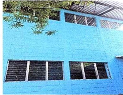
Foto 2: Sustrucción de estructura de metal de ventana.
