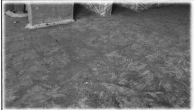
Foto 8: Es necesario el cambio e instalación de piso antideslizante en el módulo de cocina.
