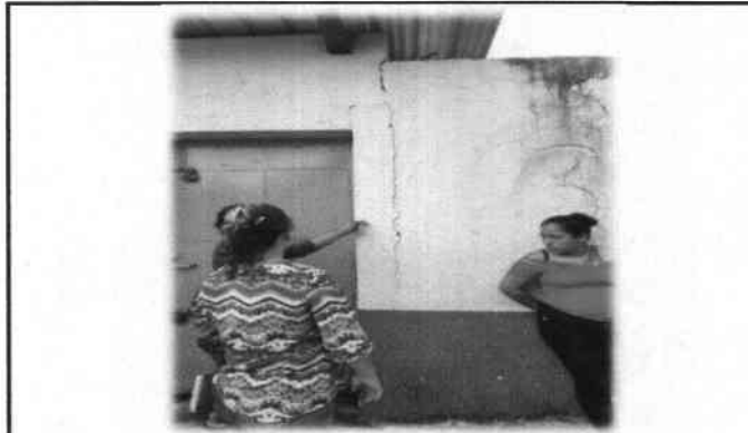
Foto 10: Es necesaria la reparación de muro inestable en fachada frontal de la Escuela Oficial Rural Mixta.
