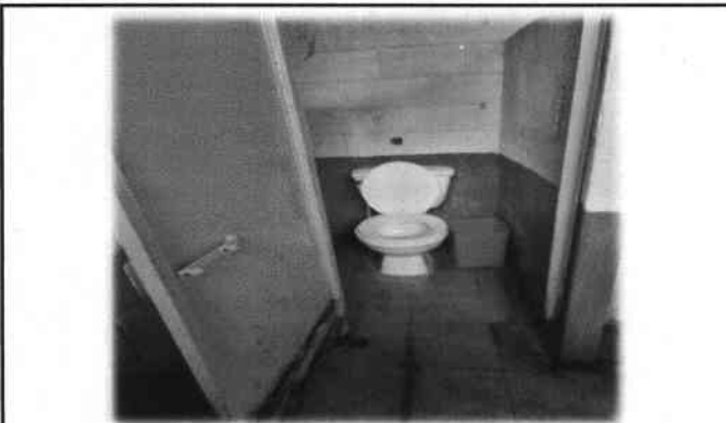
Foto 3: Mejoramiento de servicios sanitarios uno. Incluye reparación, cambio de tubería, artefactos, accesorios y azulejo y bebederos.
