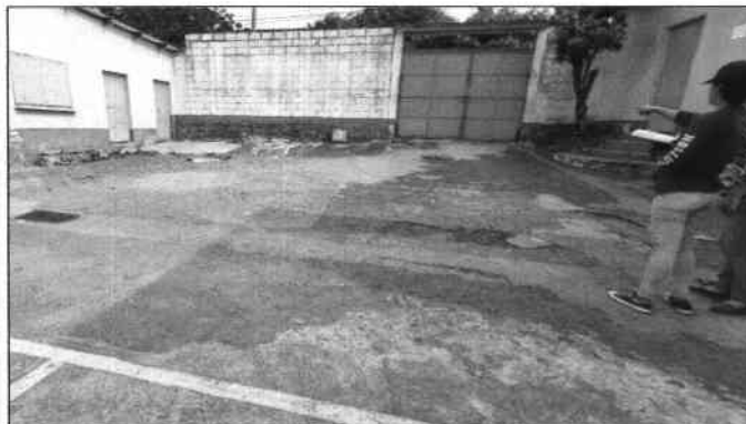
Foto 11: Se detecta la necesidad del cambio e instalación planchas de concreto de patio de ingreso a la Escuela Oficial Rural Mixta.
