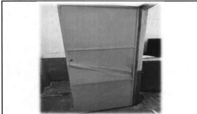
Foto 9: Es necesaria la reparación y mantenimiento de puertas, balcones y puertas de gabinetes del módulo de cocina.
