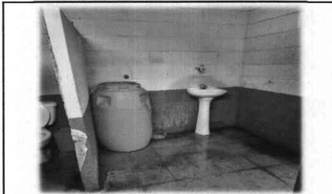
Foto 4: Mejoramiento de servicios sanitarios uno. Incluye reparación, cambio de tubería, artefactos, accesorios y azulejo y bebederos.
