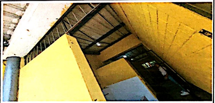
Foto 4: Reparación de circuito electrico, de iluminación y fuerza incluye accesorios en el primer modulo de servicios sanitarios.
