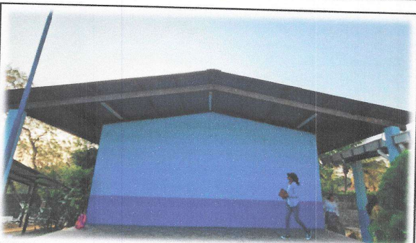
Foto 9: Módulo de aulas a ser intervenido en la estructura de soporte y lámina que se encuentran deterioradas.
