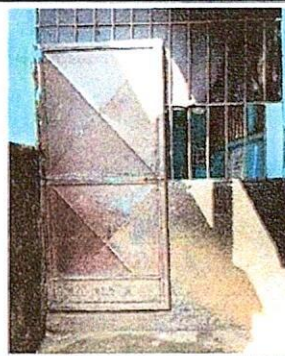
Foto 2: Sustrucción de puerta, 1ro. Grado sección "C".
