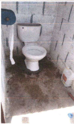
Foto 3: SERVICIOS SANITARIOS Y SUS ACCESORIOS
