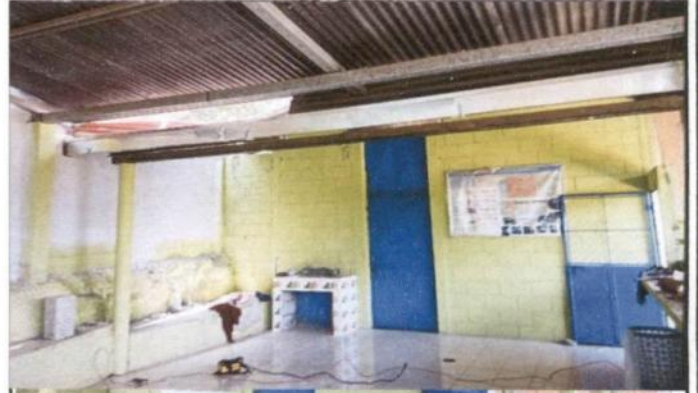
Foto 2: sustitucion de canal de plastico por de metal en el área del comedor escolar
