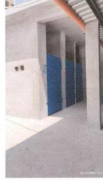
Foto 2: Servicios Sanitarios y sus accesorios.
