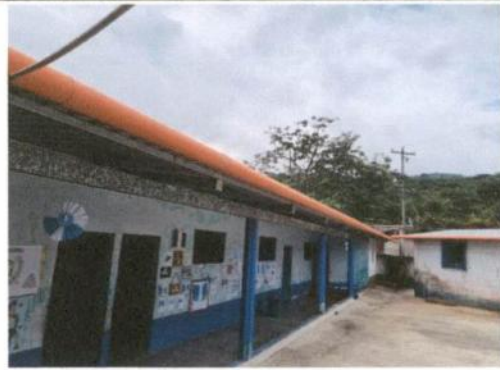
Foto 4: Canales y bajada de agua pluvial.
