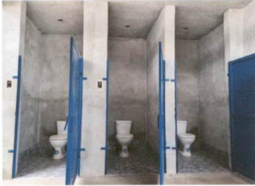
Foto1: Servicios Sanitarios y sus accesorios.
