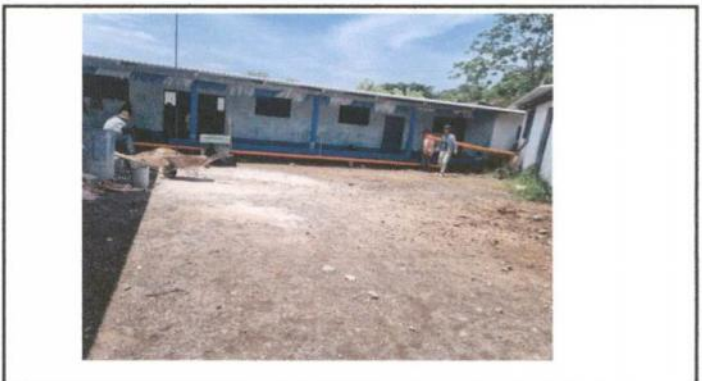
Foto 4: Canales y bajada de agua pluvial.
