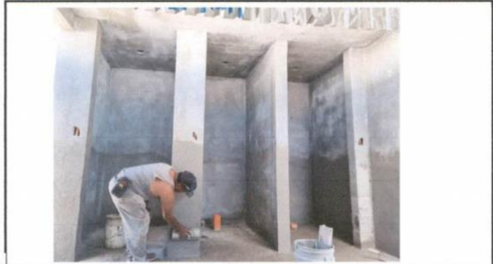
Foto1: Servicios Sanitarios y sus accesorios.
