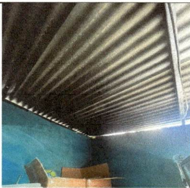
Foto 5: Módulo A, lámina en mal estado
