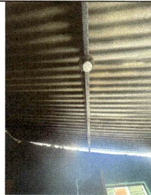
Foto 4: Módulo A, sistema eléctrico en mal estado
