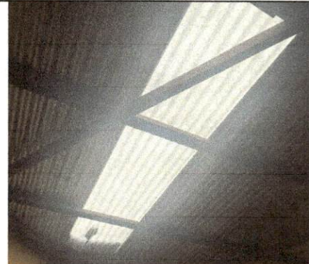
Foto 10: Módulo A, lámina en mal estado
