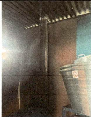
Foto 3: Módulo A, chimenea en mal estado.
