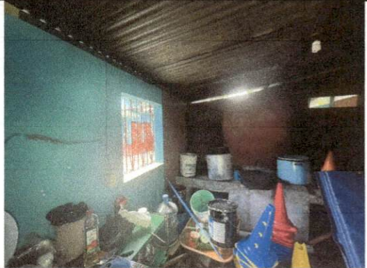
Foto 2: Módulo A, muros en mal estado en cocina
