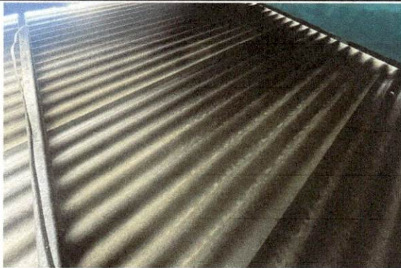
Foto 9: Módulo A, costaneras en mal estado
