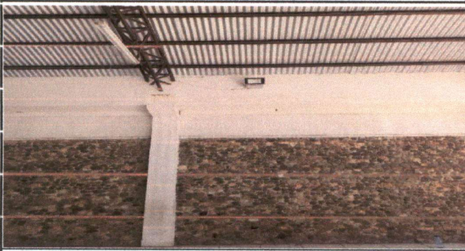
Foto 5. Lámparas LED previo a sustitución.
