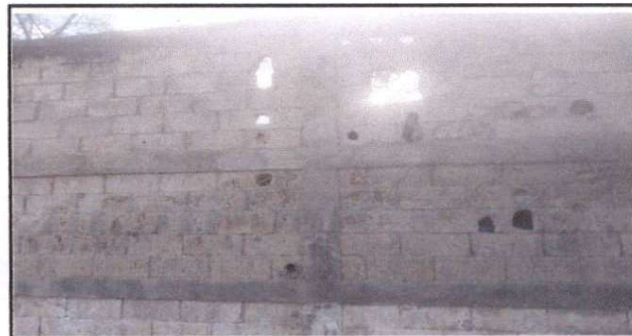
Foto 5: Muro en mal estado.
