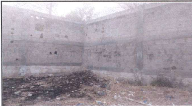
Foto 3: Muro perimetral en mal estado
