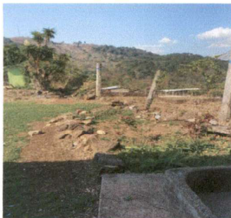
Foto 5 Muro perimetral de 42 metros lineales se ha caido
