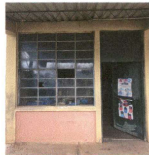
Foto 6: Puerta en mal estado
