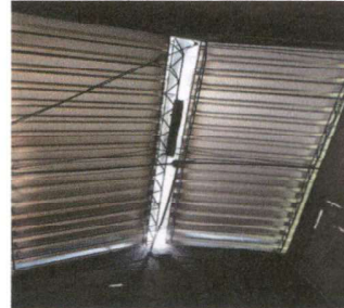
Foto 4: Instalacion de tendido electrico en mal estado
