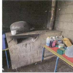
Foto 2: Hornilla en mal estado
