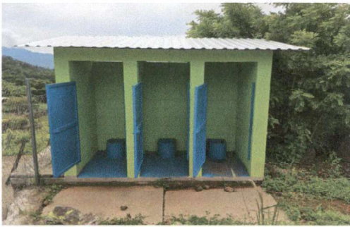
Foto 1: sustituir por inodoros
