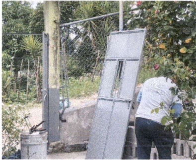
Foto 3: Proceso de mantenimiento a las puertas de los sanitarios, realizando la sujeción, lijado y pintura.
