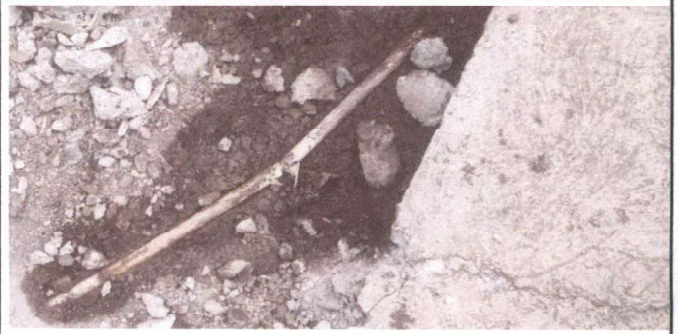
Foto 2: Red de agua potable
