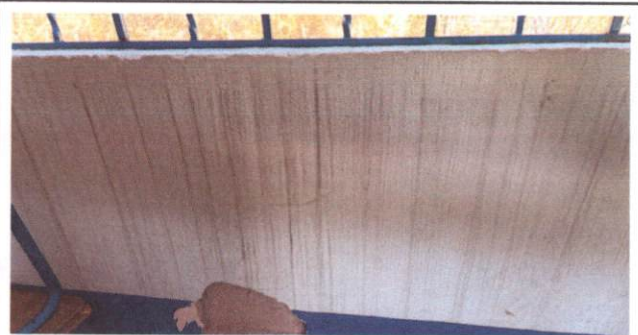
Foto 6: Pared en mal estado por filtraciones de agua.
