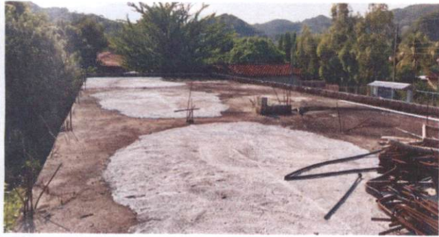
Foto 1: Terraza en mal estado.
