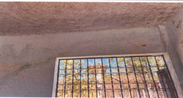
Foto 5: Filtración de agua y paredes húmedas.
