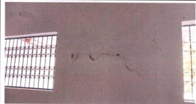
Foto 4: Paredes engrietadas por el agua acumulada en la terraza.
