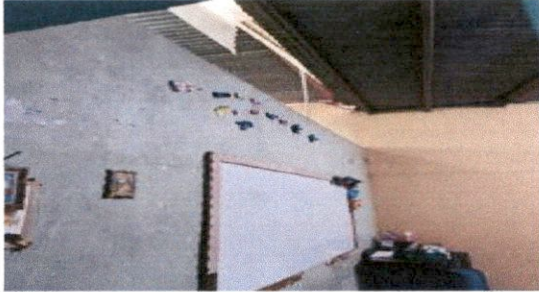
Foto No 1. techo de aula humeda
