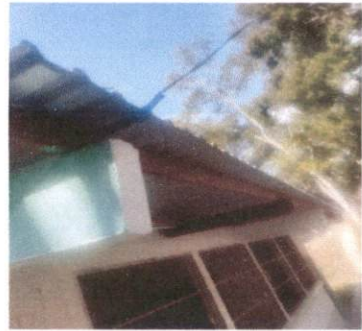
canal de agua no existe.
