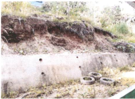
Muro de contención en mal estado
