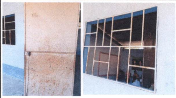
Foto 2: puertas y ventanas se encuentran oxidadas.
