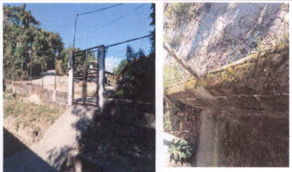
Foto 3: muro perimetral de la escuela en malas condiciones.
