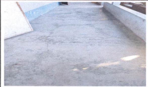
Foto 4: piso de torta de cemento en mal estado.
