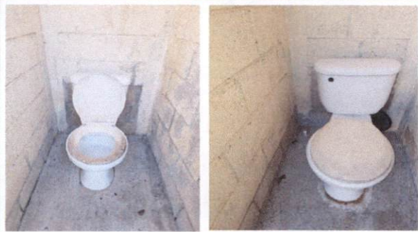
Foto 1: sanitarios sin accesorios y en mal estado.
