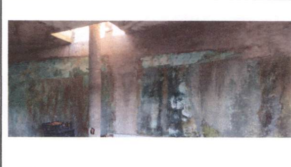
Foto 6: pintura de interiores en mal estado.
