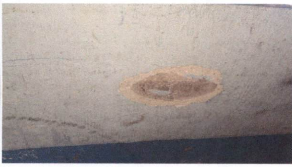
Foto 5: pintura de exterior en mal estado.
