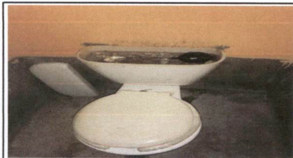
FOTO 5: SANITARIOS EN MAL ESTADO
