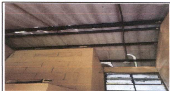
FOTO 6: TECHO DE AULA EN MAL ESTADO
