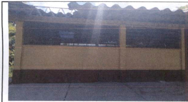
FOTO 3: TECHO EN MAL ESTADO
