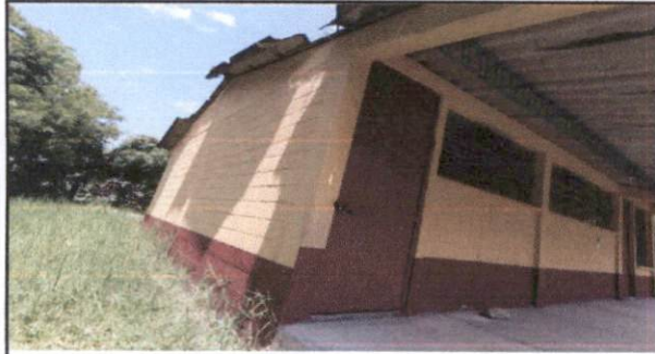
FOTO 1: TECHO EN MAL ESTADO
