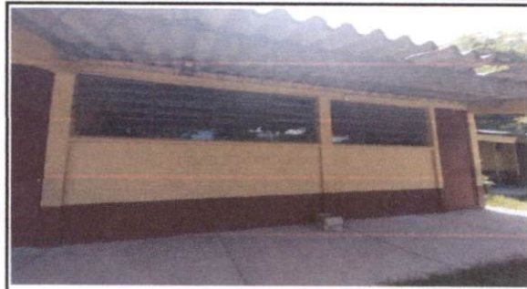
FOTO 2: TECHO EN MAL ESTADO CORREDOR
