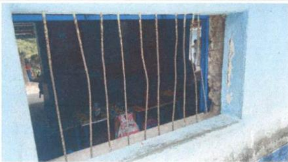
Foto 5: Balcones en malas condiciones.
