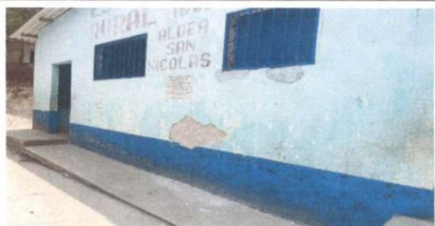
Foto 6: Repello de la escuela en mal estado.
