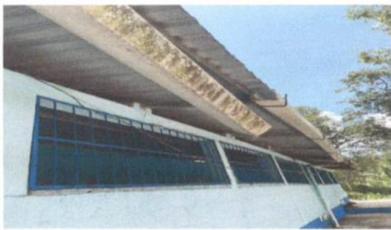
Foto 3: Canal de metal en malas condiciones.
